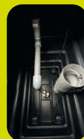
Clarificateur Pompe à boues
